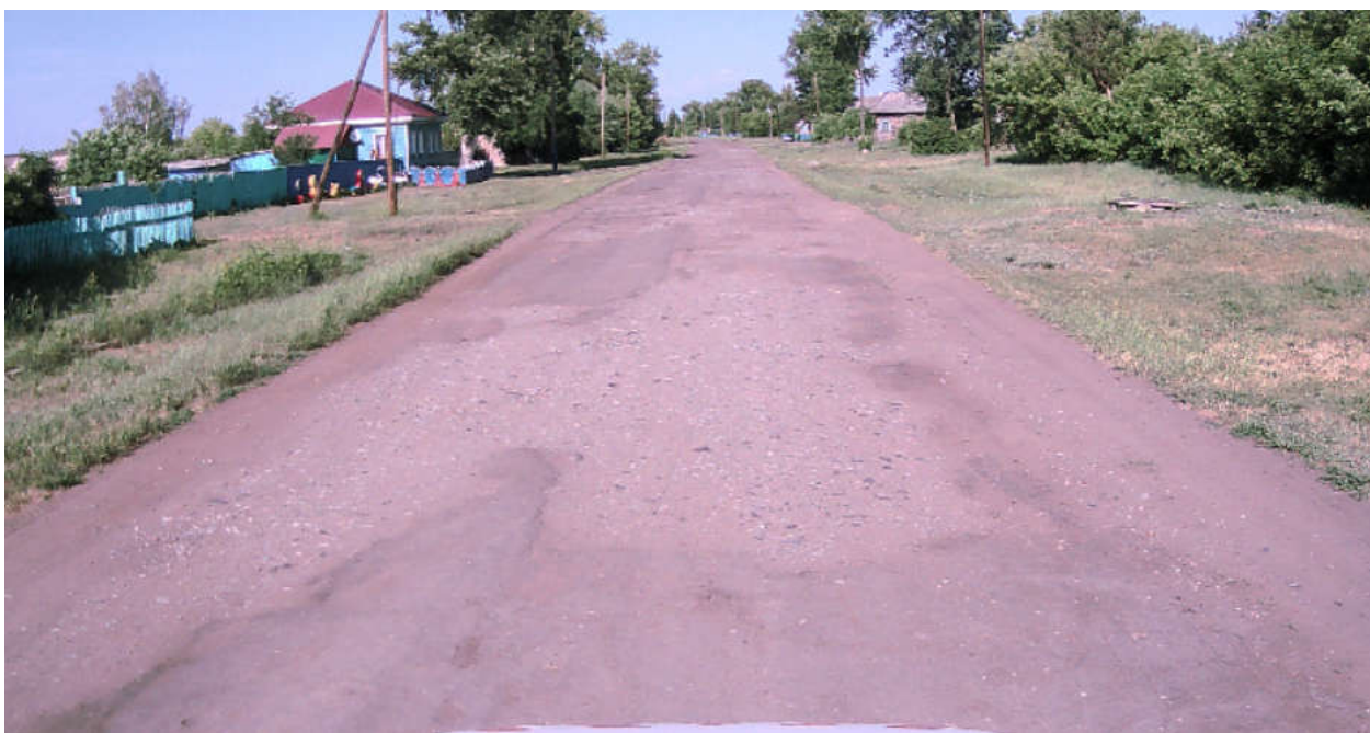
Рисунок 4.1.7– Состояние покрытия на участке ПК 1+255
