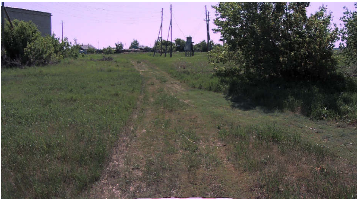
Рисунок 3.2.5 – Состояние покрытия на участке ПК 0+277
