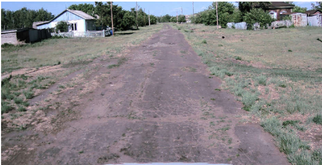
Рисунок 4.1.10– Состояние покрытия на участке ПК 2+334
