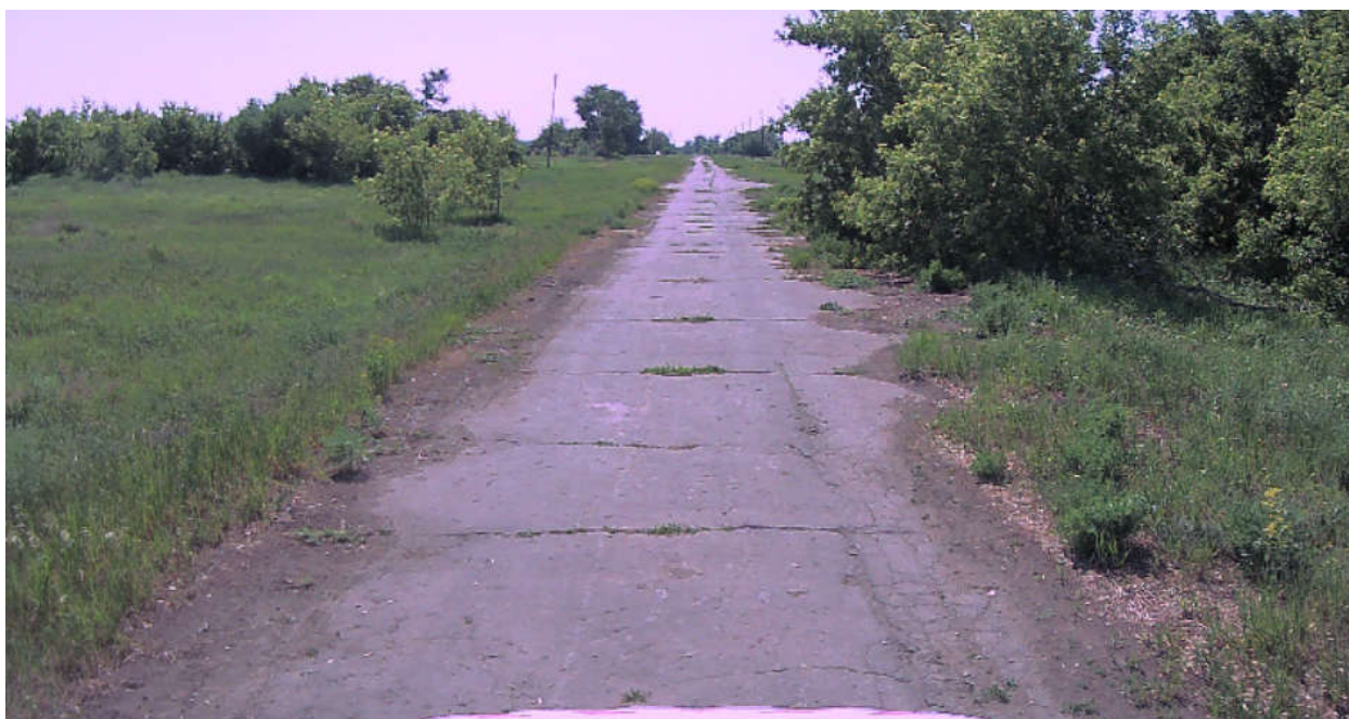
Рисунок 3.4.4 – Состояние покрытия на участке ПК 0+069
