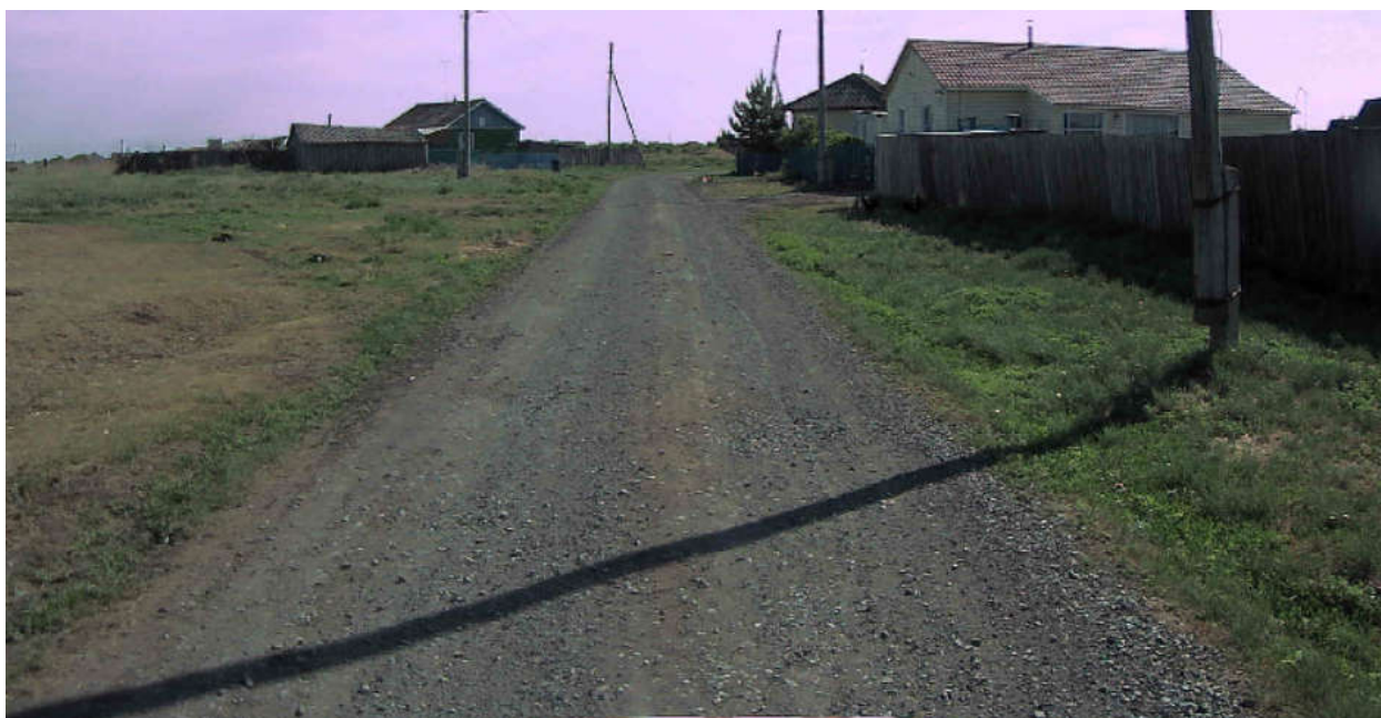
Рисунок 2.3.4 – Состояние покрытия на участке ПК 0+117
