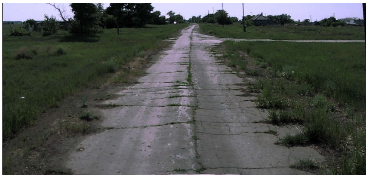
Рисунок 3.4.5– Состояние покрытия на участке ПК 0+234
