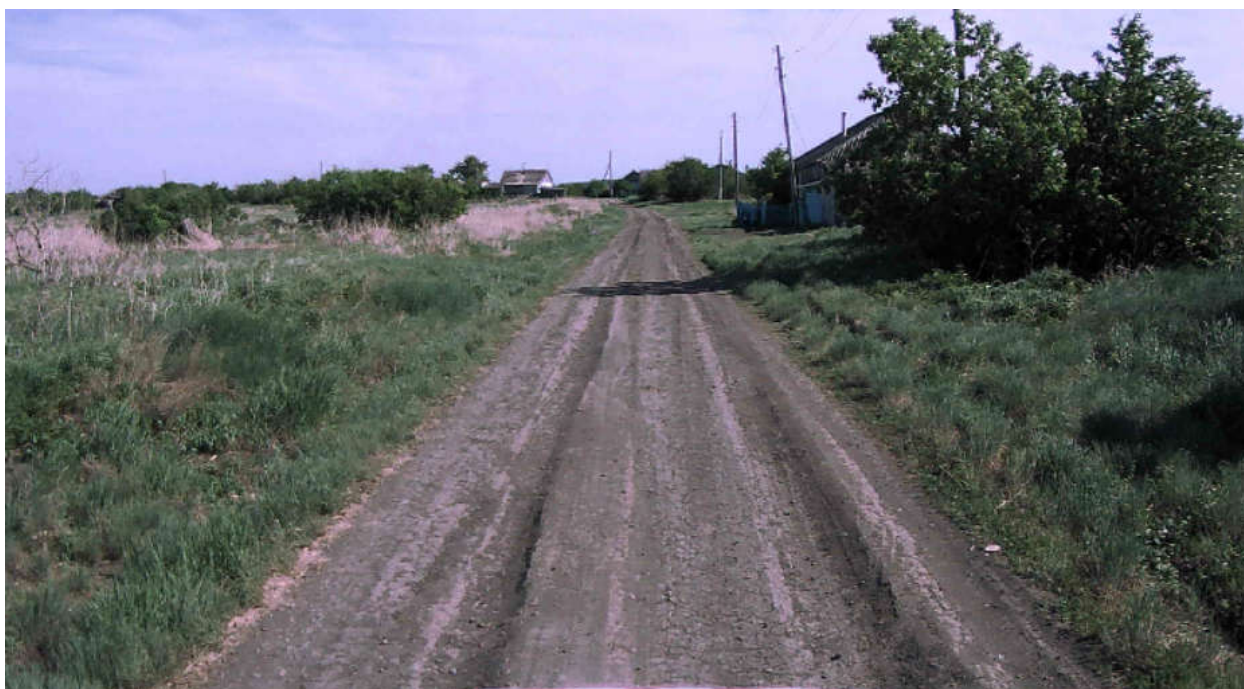
Рисунок 2.6.4 – Состояние покрытия на участке ПК 0+058
