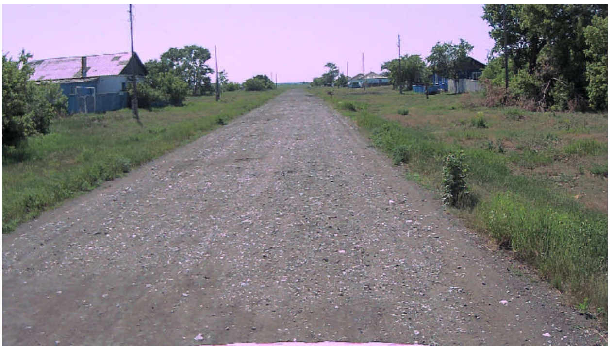
Рисунок 3.1.8 – Состояние покрытия на участке ПК 1+329
