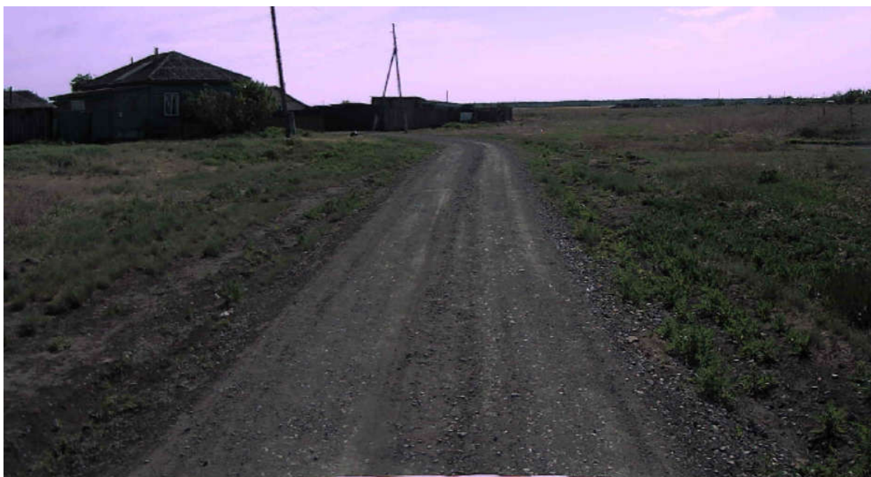
Рисунок 2.7.4 – Состояние покрытия на участке ПК 0+161
