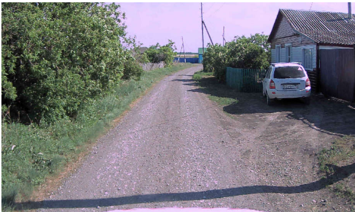
Рисунок 2.7.5 – Состояние покрытия на участке ПК 0+348
