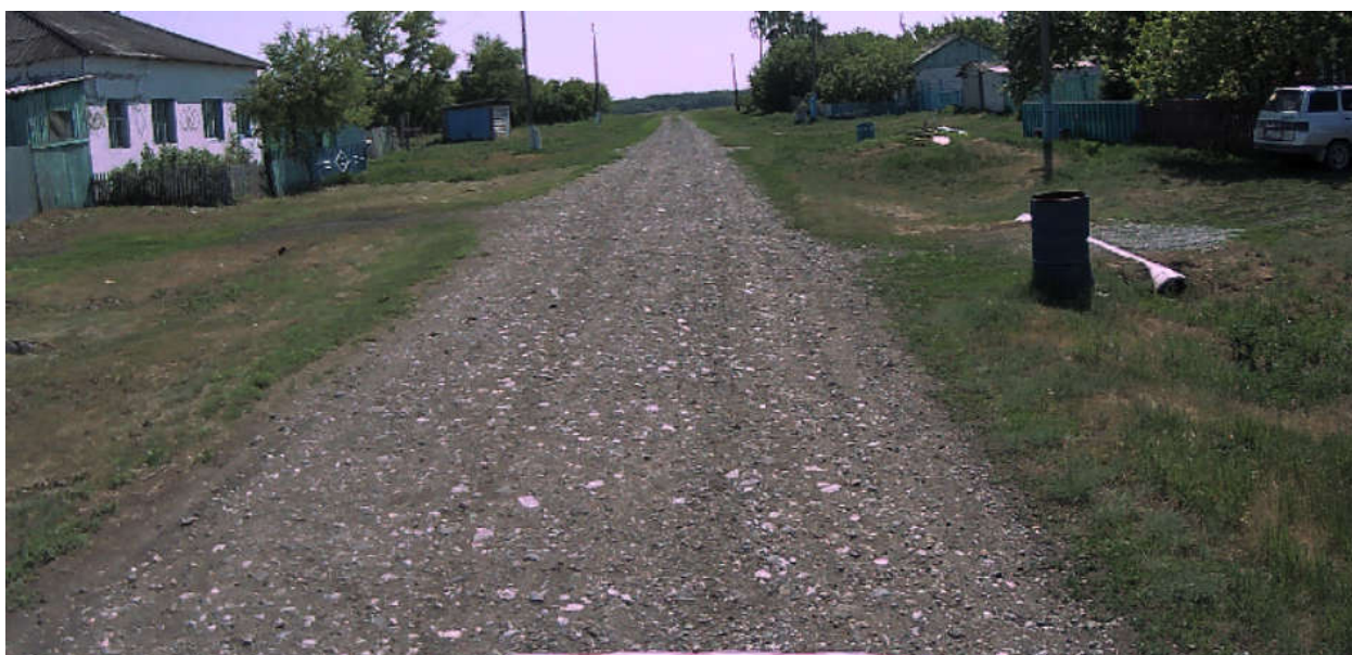
Рисунок 5.1.6 – Состояние покрытия на участке ПК 0+948
