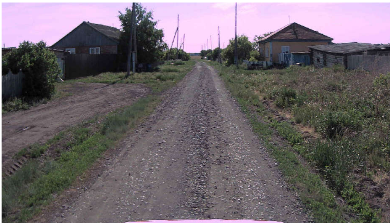
Рисунок 2.3.5 – Состояние покрытия на участке ПК 0+442
