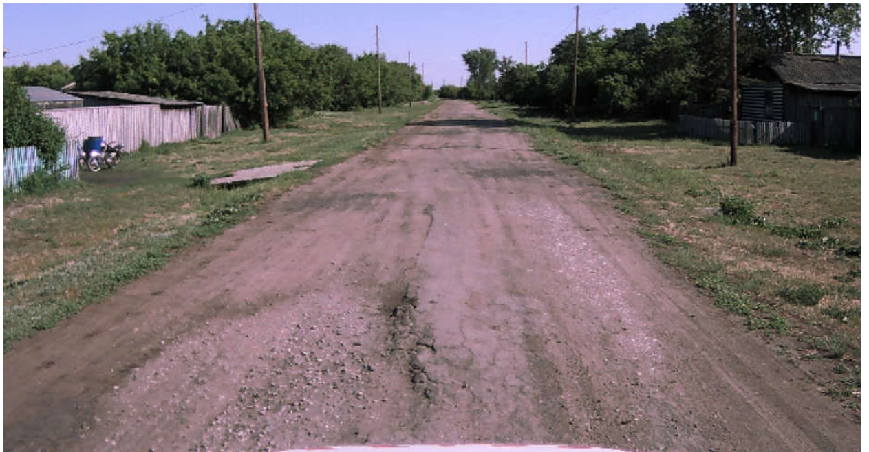
Рисунок 4.1.4 – Состояние покрытия на участке ПК 0+227
