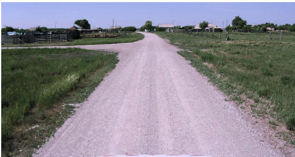
Рисунок 3.5.4 – Состояние покрытия на участке ПК 0+113
