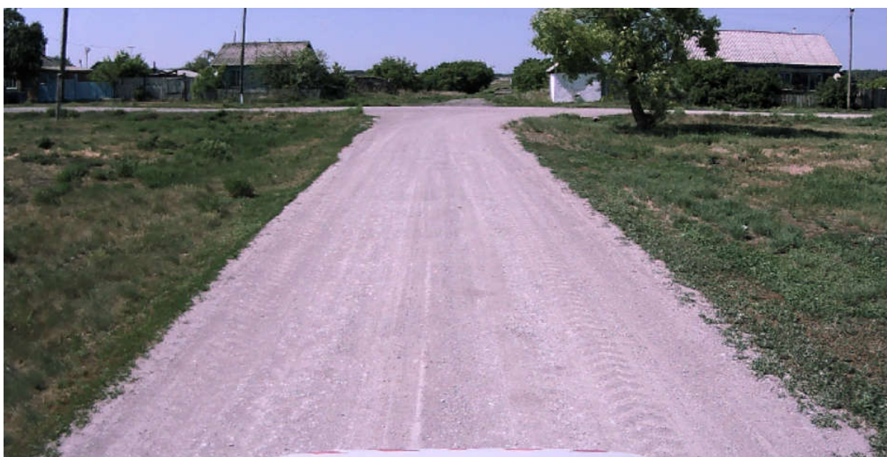
Рисунок 3.5.5– Состояние покрытия на участке ПК 0+261
