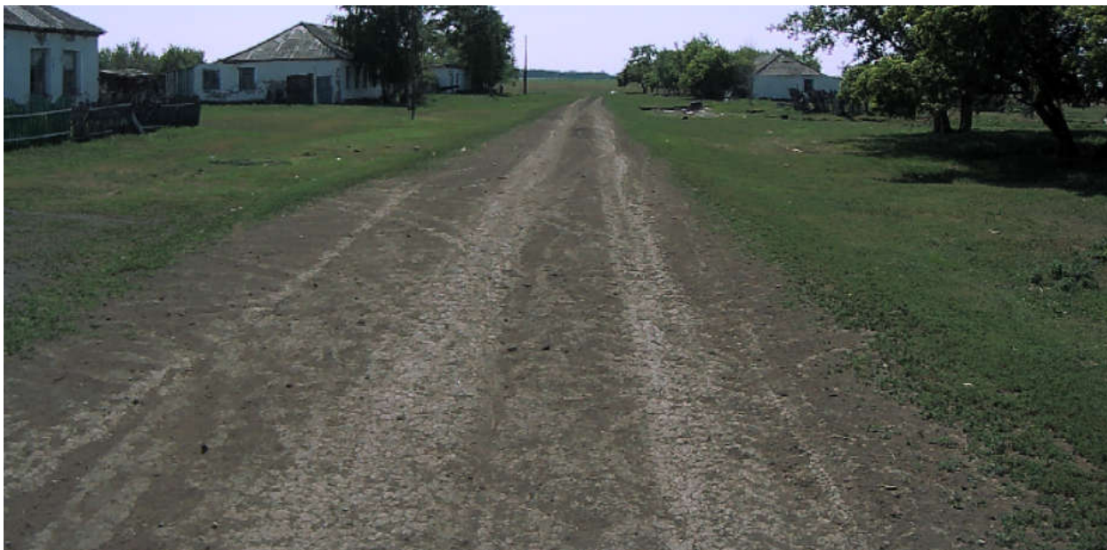
Рисунок 3.4.8 – Состояние покрытия на участке ПК 1+197
