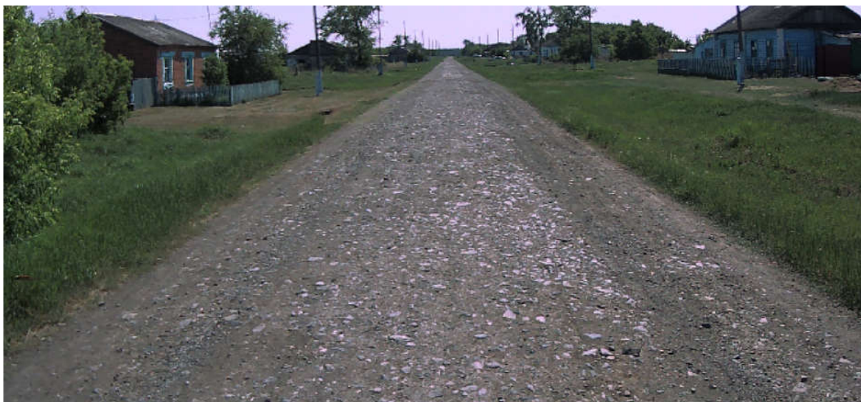
Рисунок 5.1.5 – Состояние покрытия на участке ПК 0+609
