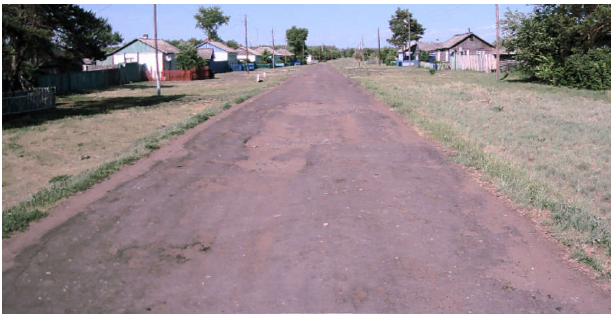
Рисунок 4.1.9– Состояние покрытия на участке ПК 2+110
