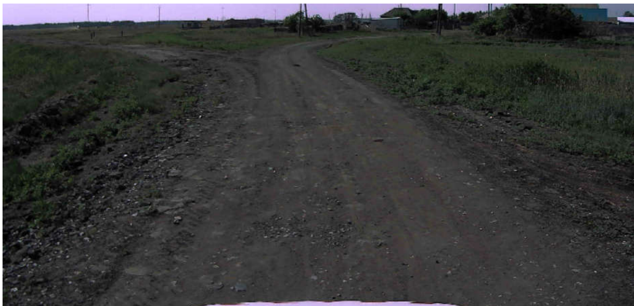
Рисунок 2.5.4 – Состояние покрытия на участке ПК 0+099
