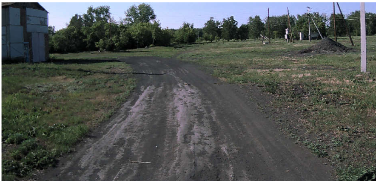
Рисунок 4.2.5 – Состояние покрытия на участке ПК 0+156
