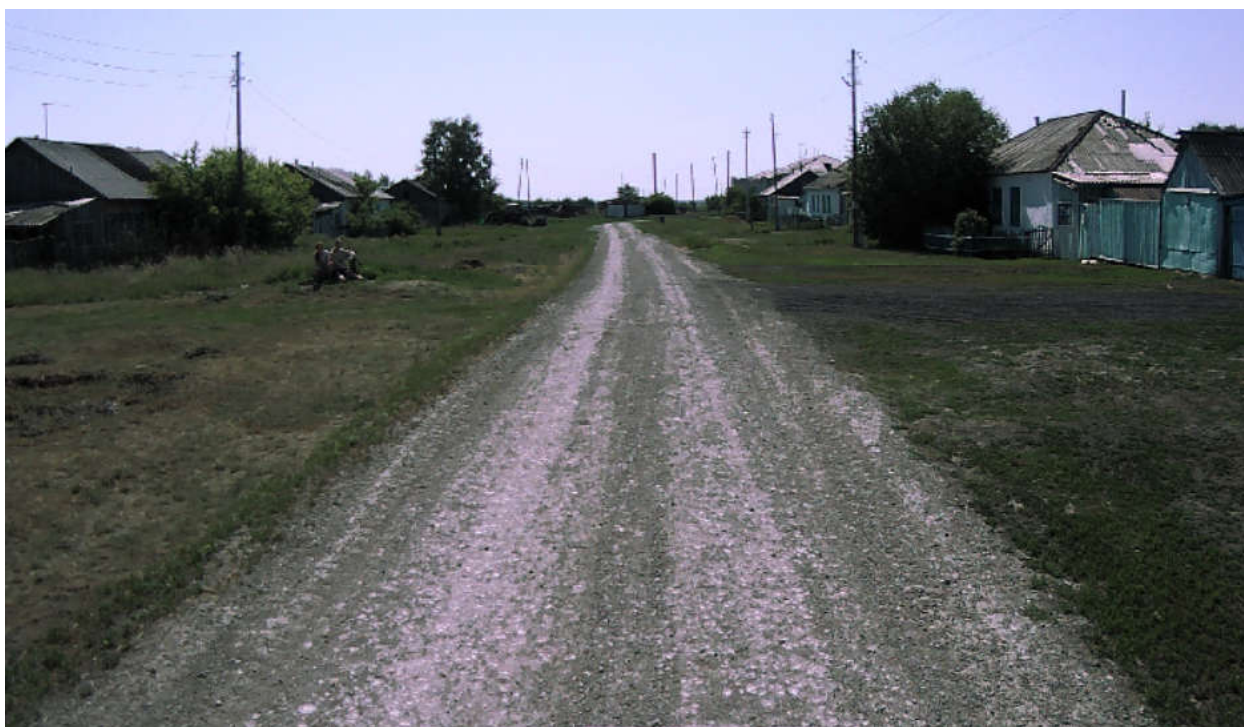
Рисунок 3.3.4 – Состояние покрытия на участке ПК 0+040
