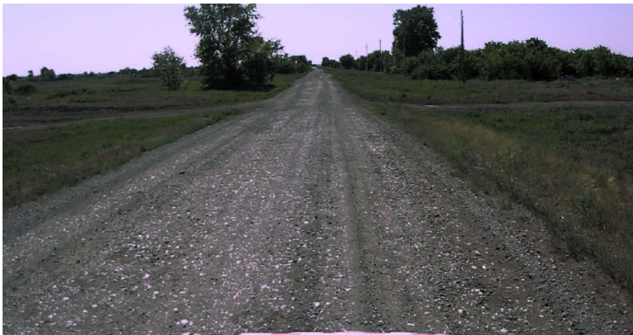
Рисунок 3.1.4 – Состояние покрытия на участке ПК 0+088
