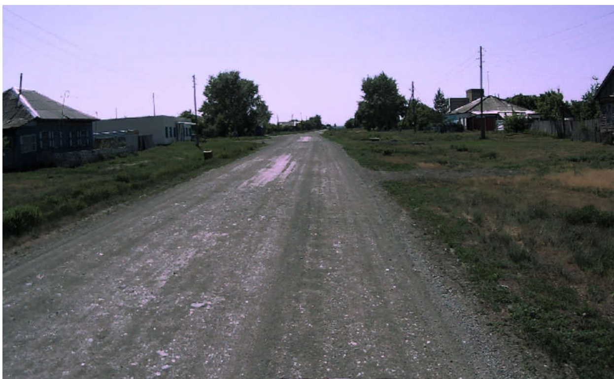
Рисунок 3.1.6 – Состояние покрытия на участке ПК 0+743
