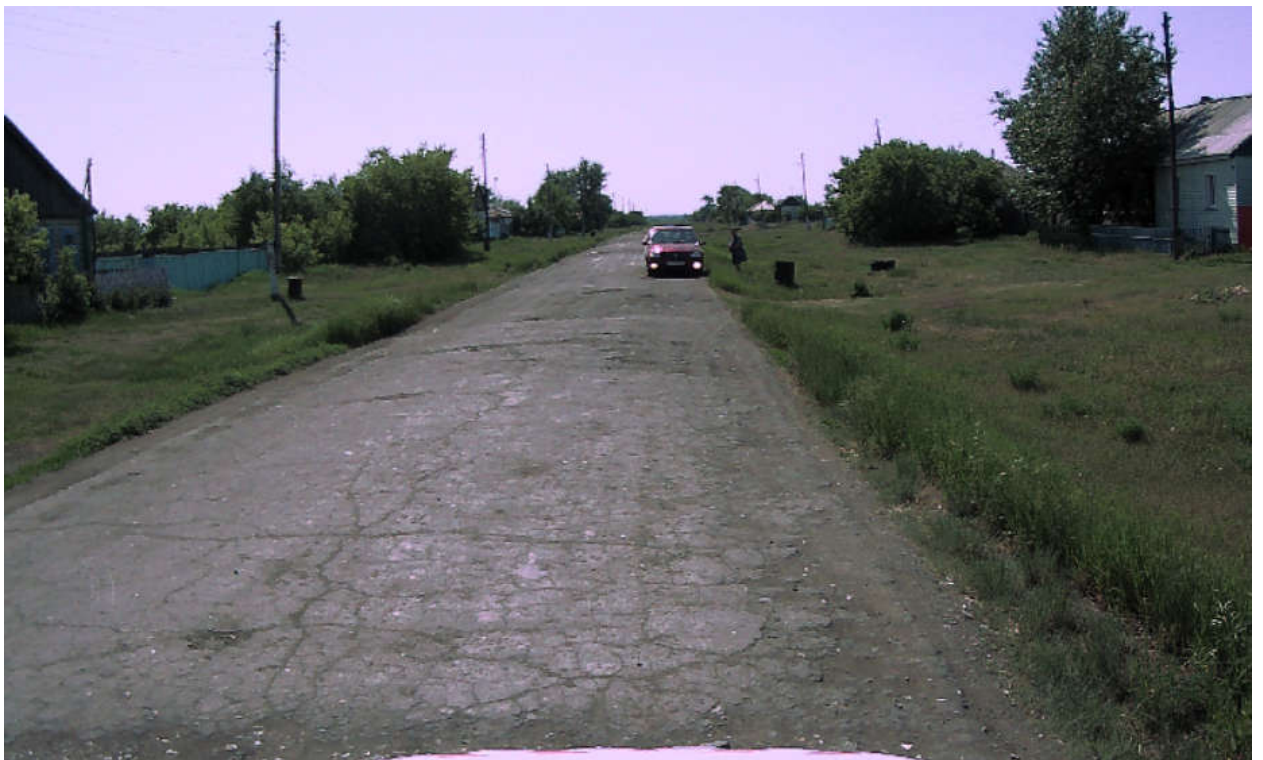
Рисунок 3.1.7 – Состояние покрытия на участке ПК 1+036
