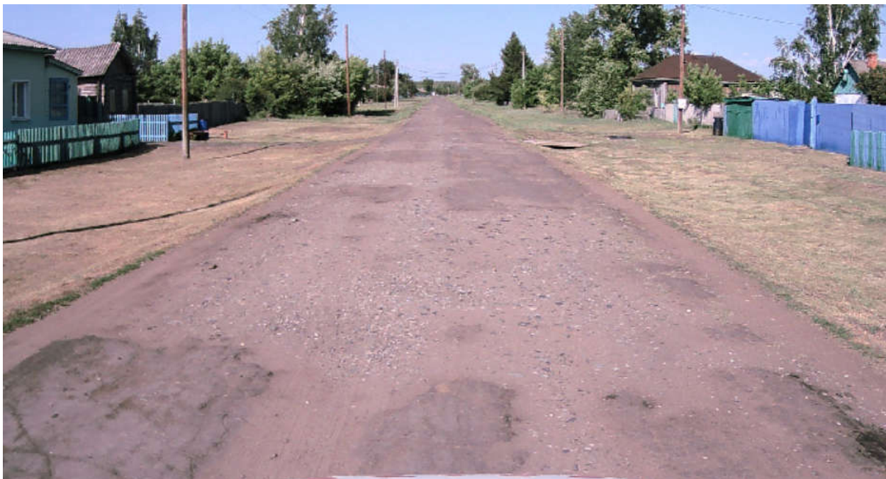
Рисунок 4.1.8– Состояние покрытия на участке ПК 1+701
