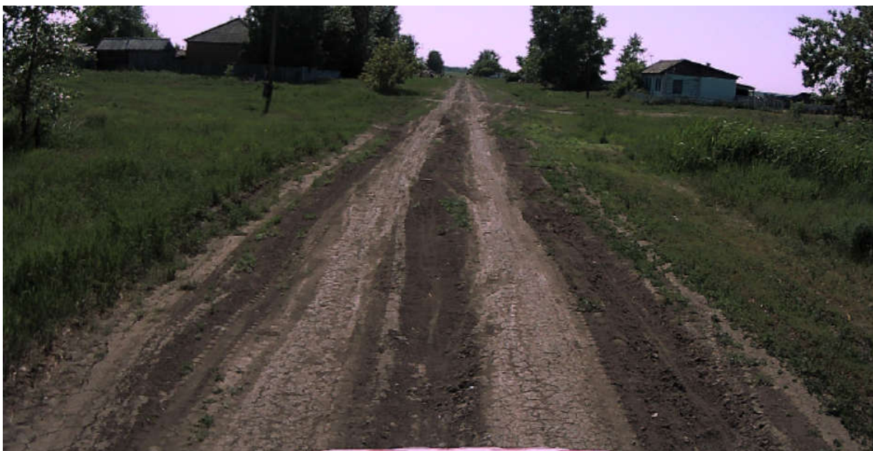
Рисунок 3.4.7 – Состояние покрытия на участке ПК 0+845
