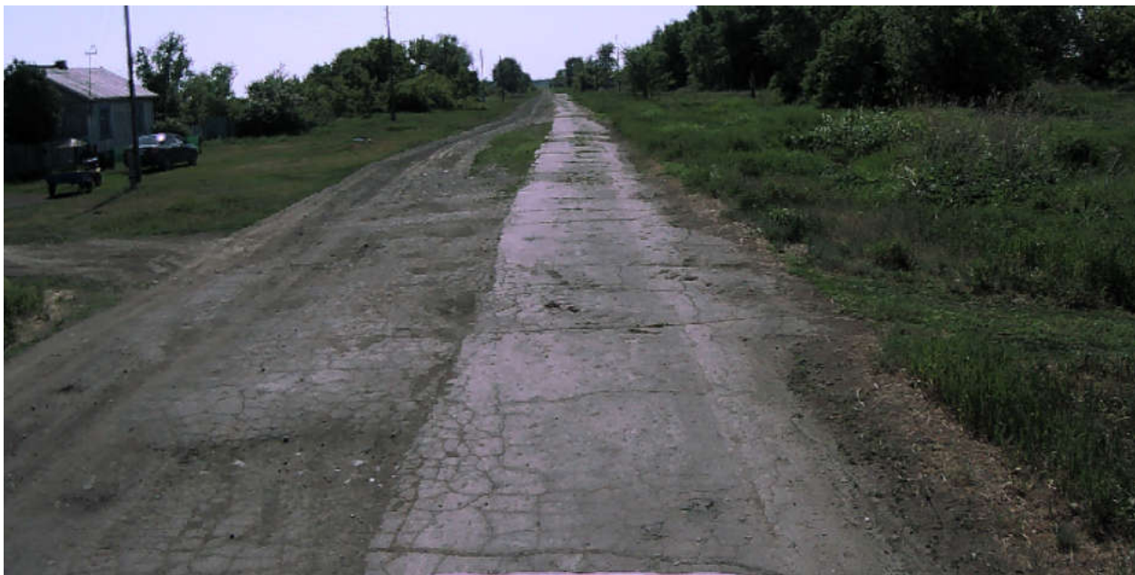
Рисунок 3.4.6 – Состояние покрытия на участке ПК 0+472
