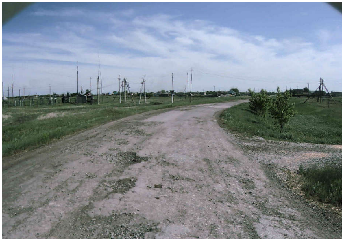
Рисунок 2.2.4 – Состояние покрытия на участке ПК 0+032
