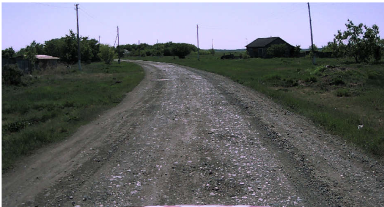
Рисунок 5.1.4 – Состояние покрытия на участке ПК 0+211
