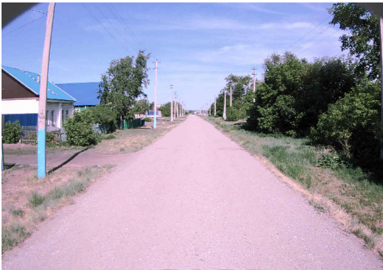
Рисунок 2.1.5 – Состояние покрытия на участке ПК 0+504
