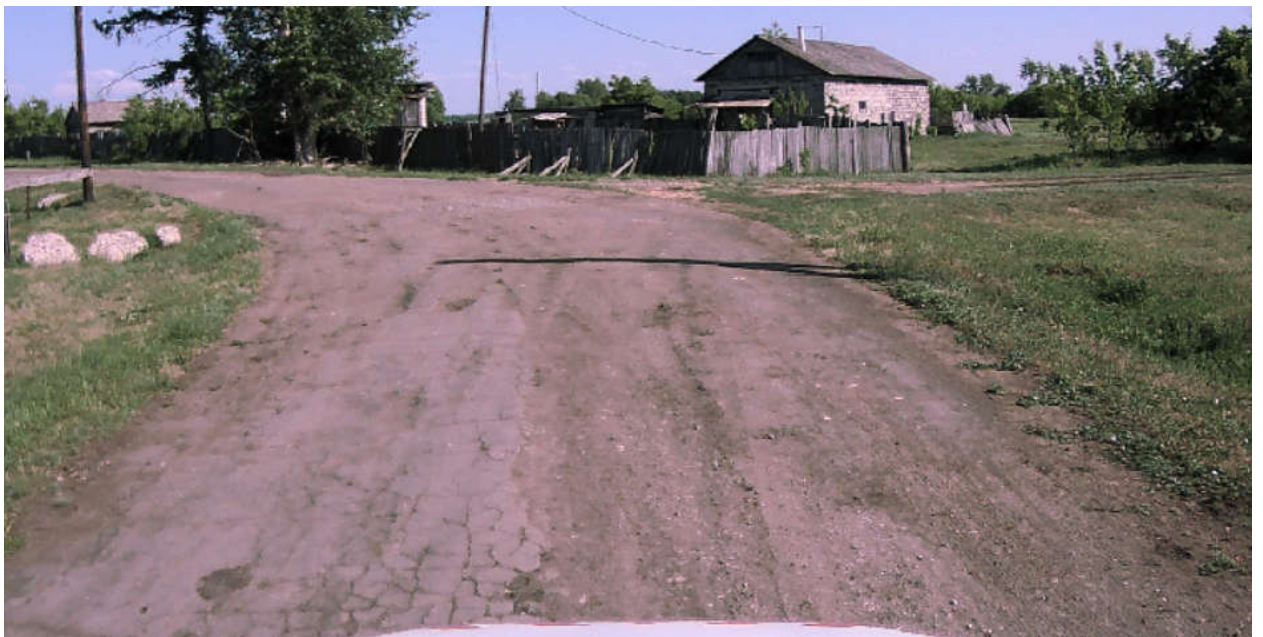
Рисунок 4.1.5 – Состояние покрытия на участке ПК 0+593
