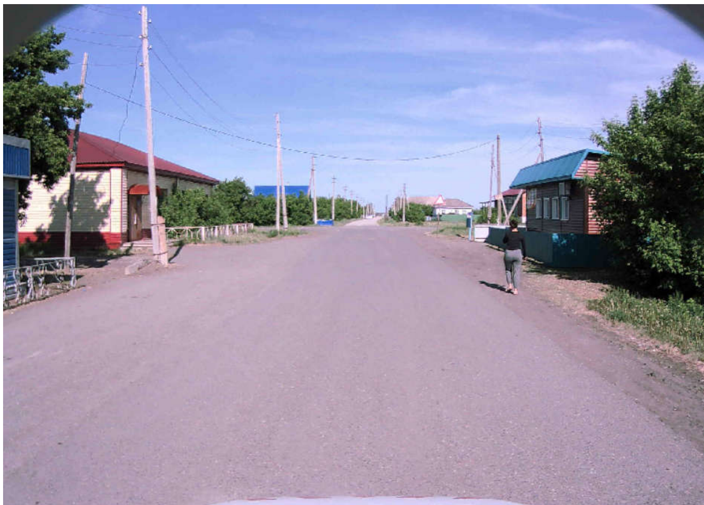
Рисунок 2.1.4 – Состояние покрытия на участке ПК 0+101
