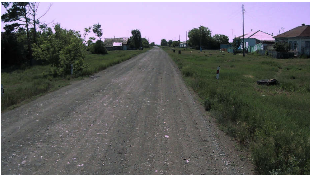
Рисунок 3.1.5 – Состояние покрытия на участке ПК 0+344
