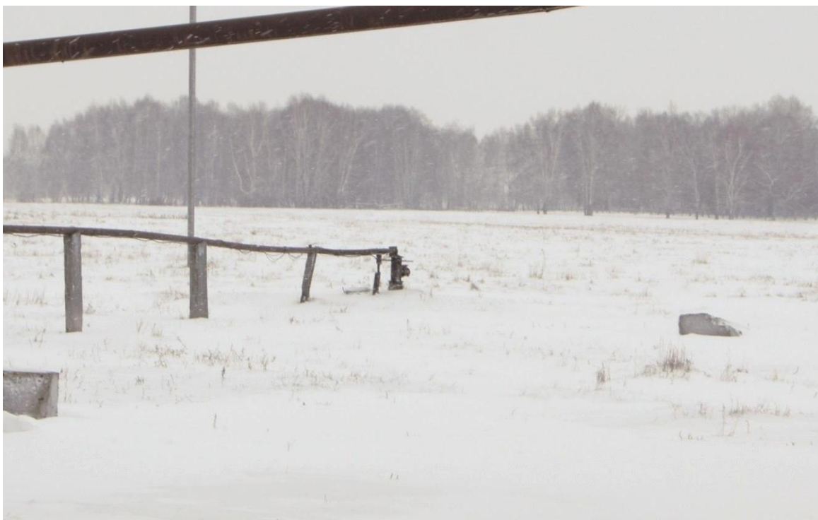
Рисунок 2.2 – Оголовок скважины № 59 «Г» системы централизованного водоснабжения с. Новоалександровка
