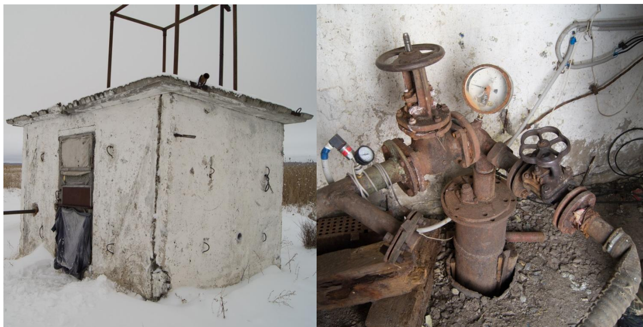
Рисунок 2.2 – Павильон скважины № 196-Г системы централизованного водоснабжения с. Казаткуль
